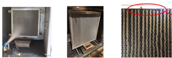
中性能フィルタ 濾材の破損(外れ)
