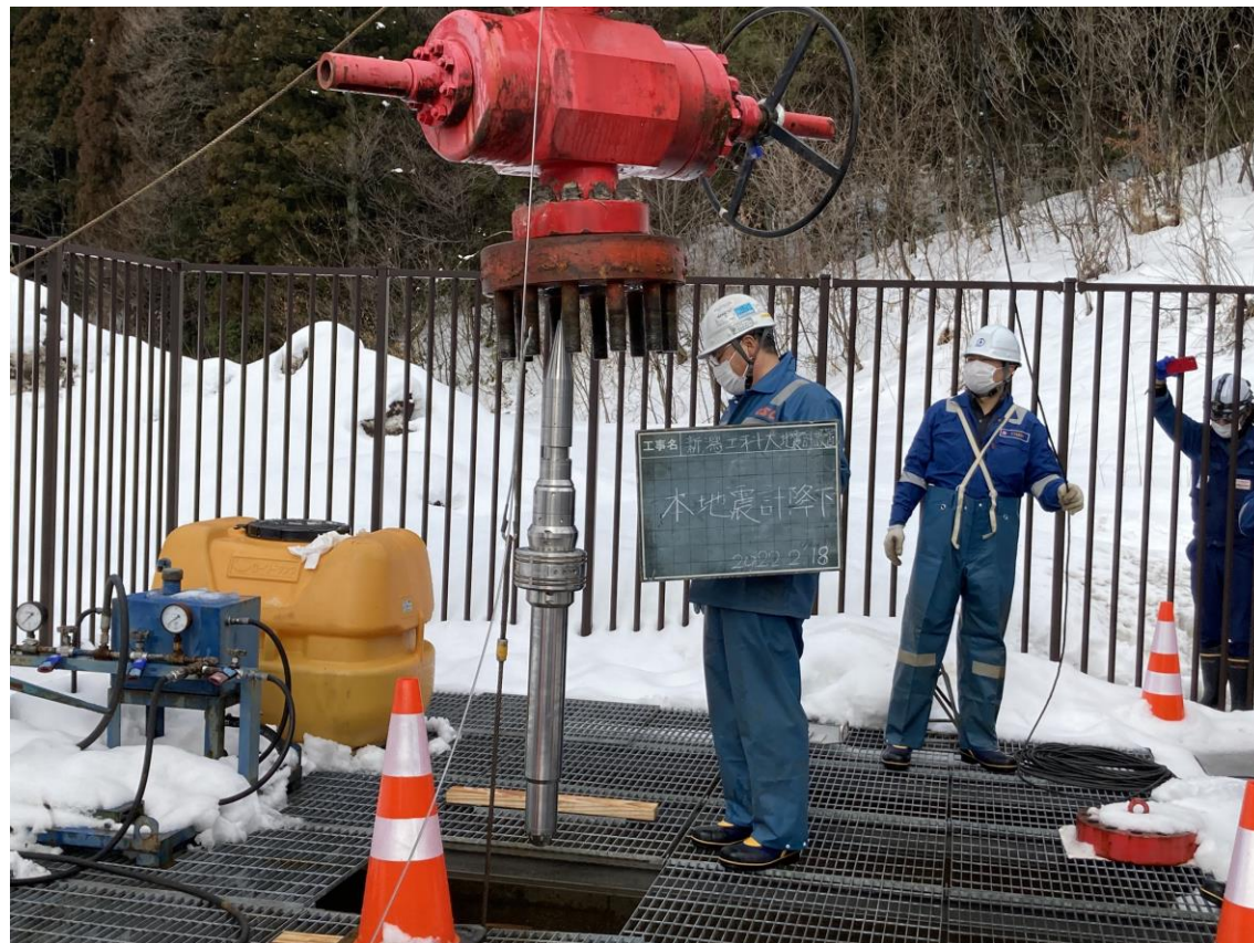
ボアホールタイプセンサー@新潟工科大学 2022年
