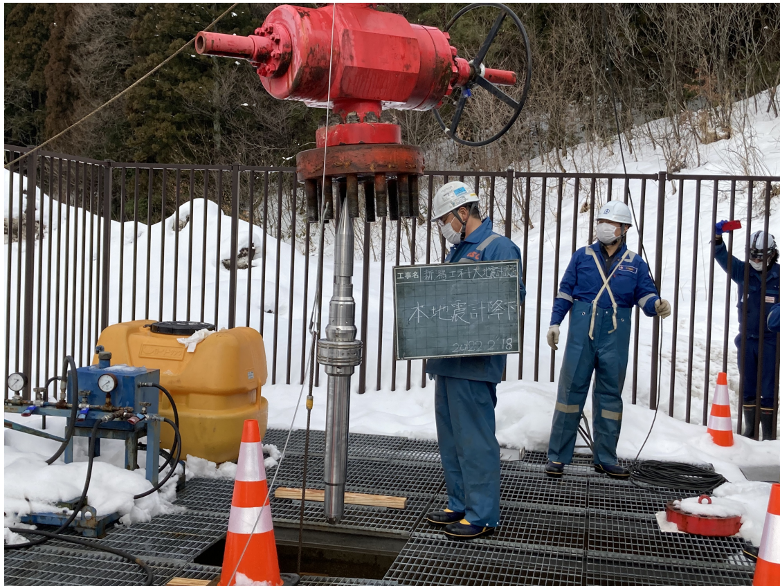
高温対応光センサの光センサの大深度観測井への設置作業風景
