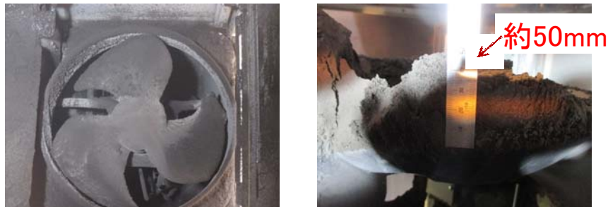
図 22 室外機ファンに堆積した火山灰
