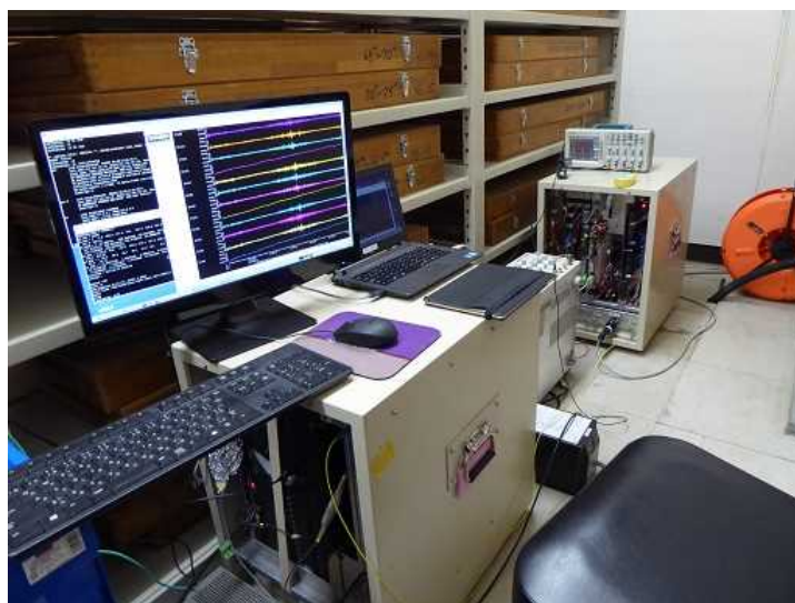
写真 3 観測室内の光送受信装置の設置状況
